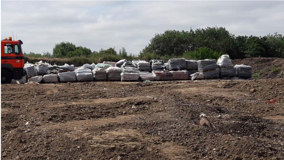
Figur 4 deponering af asbest, der er pakket ind i plast overdækkes ikke dagligt.
