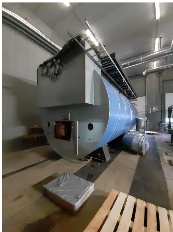
Kedel placeret i kedelhuset - ikke i brug.
