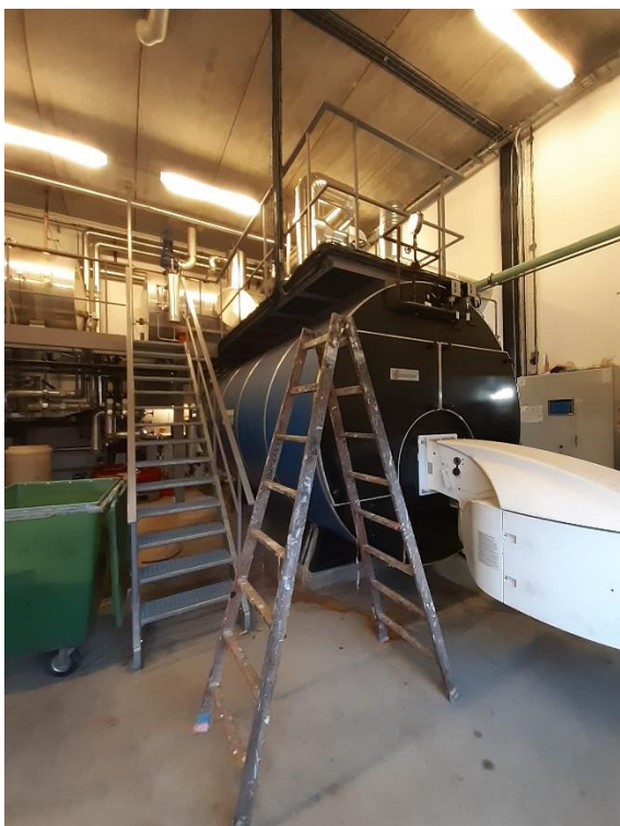
Kedel 20 placeret i kedelhuset.
