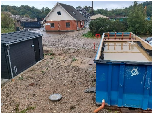
Sandfilter og pumpehus til nyt forrenseanlæg
