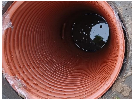
Brøndrør skåret af ved jordoverfladen
