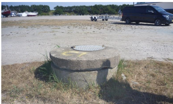
Figur 4: Perkolat brønden C1 er beliggende ved vinter oplagspladsen. I brønden er installeret en perkolat pumpe.
