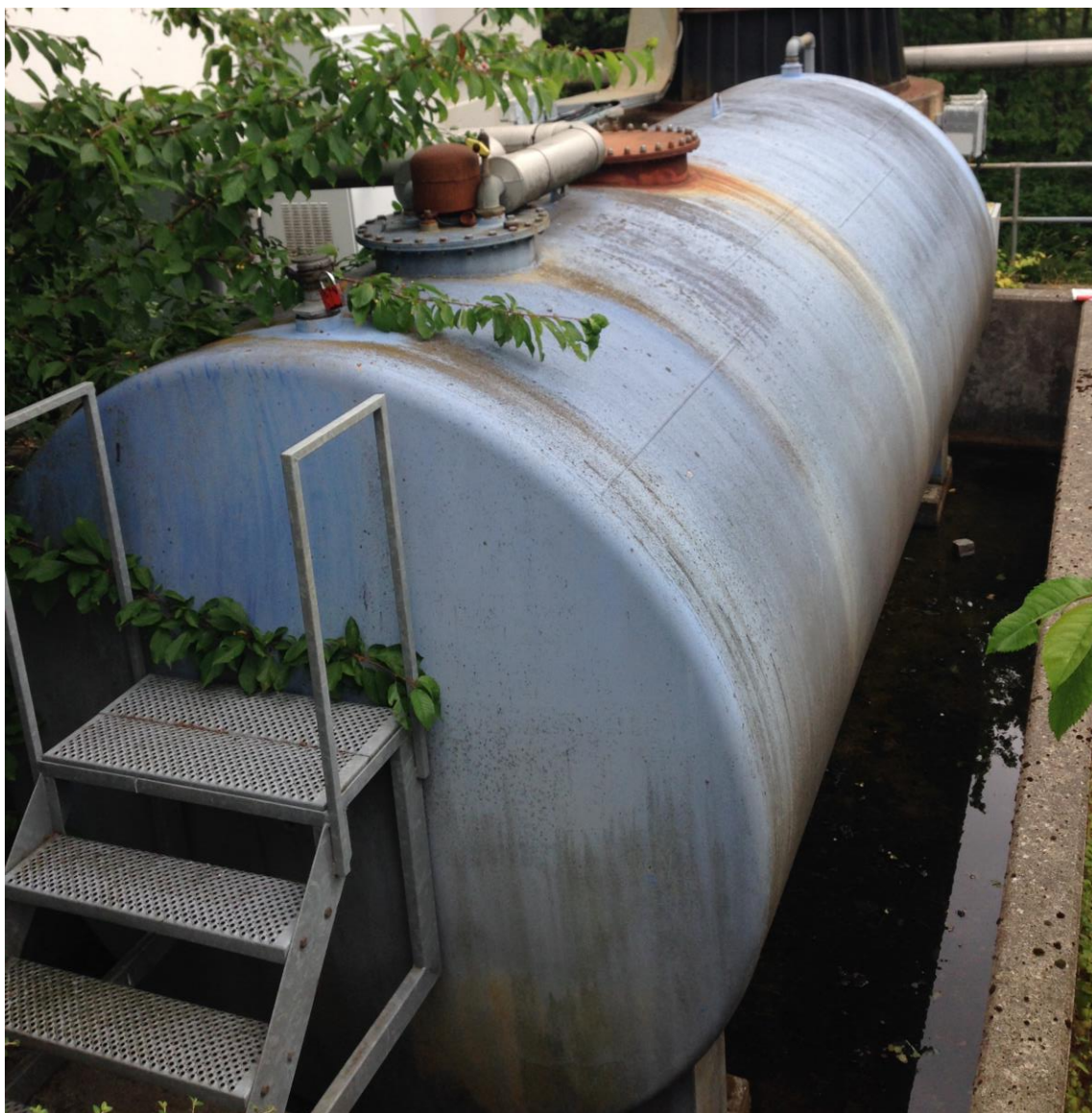
Værkets olietank i tankgrav af beton
