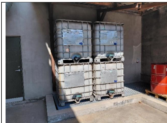
Opbevaring af olieprodukter mv på spildbakke og under halvtag.
