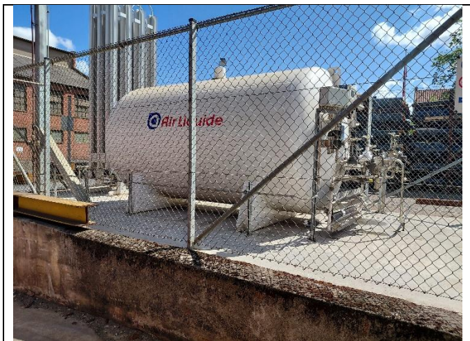
Oxygentank etableret i 2022.
