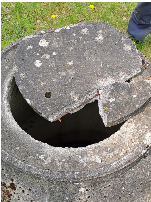
Foto 13, dæksel til brønd for overfladevand.
