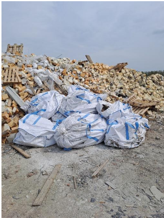
Foto 19. Asbestaffald på celle 4 for mineralsk affald.
