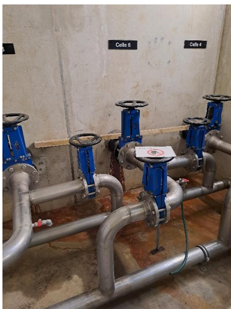
Foto 26. Udløbsrør fra celle 4 og 6 i pumpehus (den nye del).
