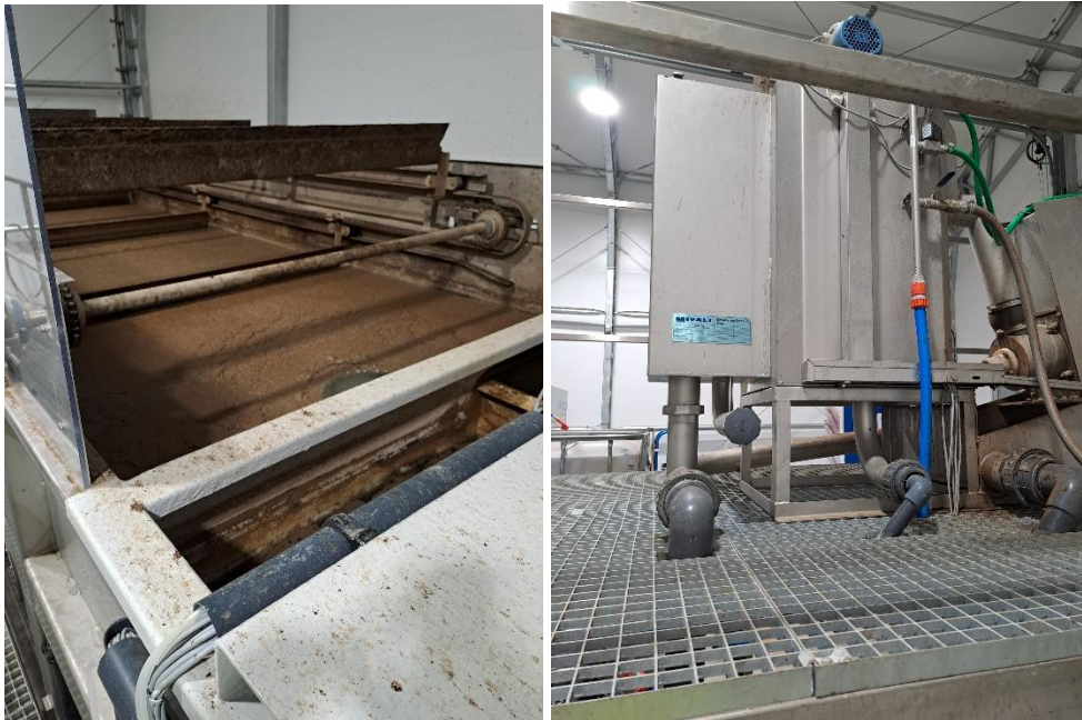
Foto 7 og foto 8 (højre). Forrenseanlæg til PFAS-rensning af perkolat.
