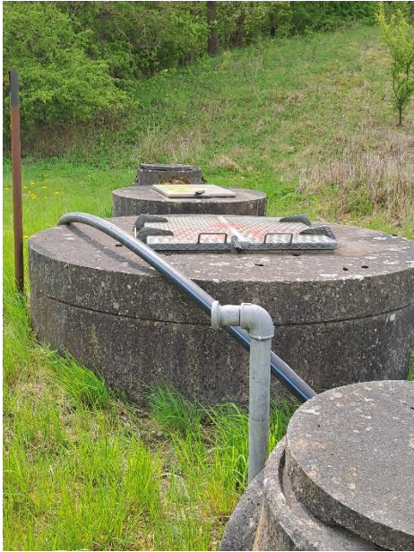
Foto 14. Sandfang og Olieudskiller til overfladevand.
