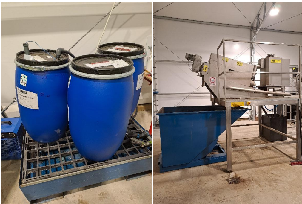
Foto 9 og foto 10. Oplag af kemi til forrenseanlæg, højre side: snegl til spildevandsslam
