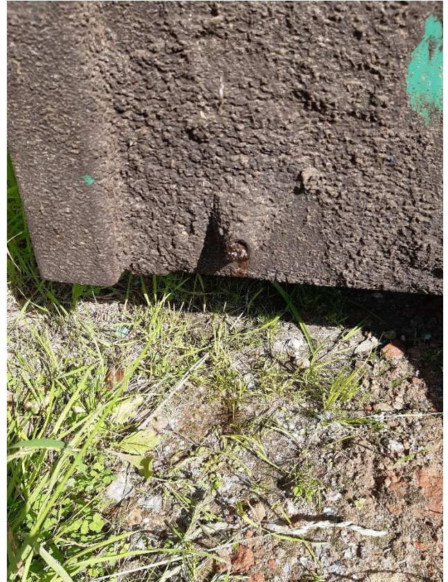
Studs, hvorfra væske med olielugt drypper.
