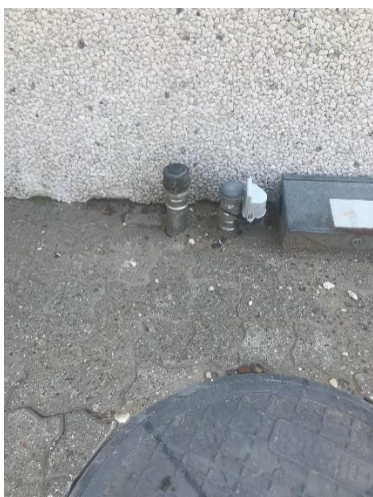
Billede 5. Påfyldningsstuds til nedgravet fyringsolietank
