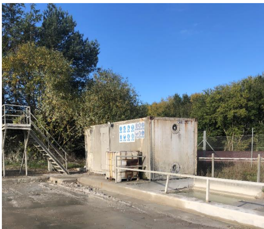
Billede 2. Palletank som er placeret udenfor i tilknytning til neutraliseringsanlægget.
