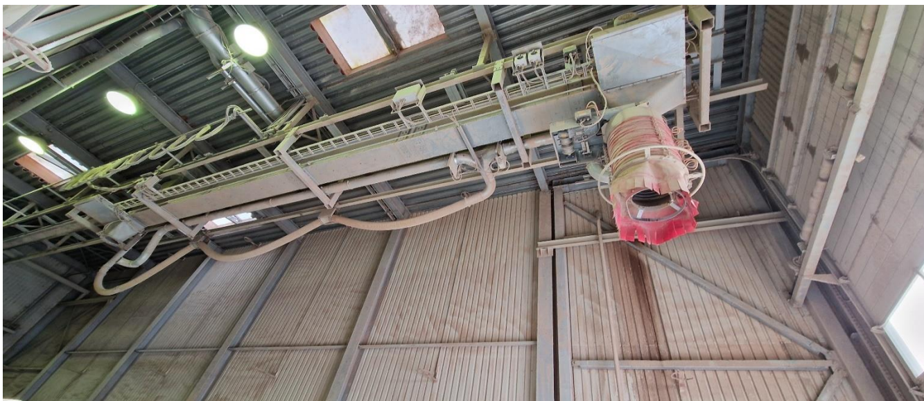
Udlevering af produkt i løs vægt er påmonteret bælg med udsugning for at minimere støvemission.
