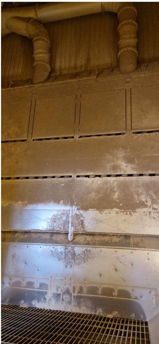
Udsugning på endevæg i påslag.
