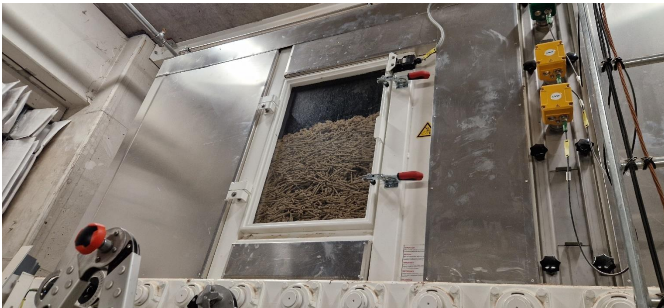
Frøskaller fra egen produktion presses til pellets i dette presseanlæg. Frøskalle-pillets afsættes delvist til foderproduktion og benyttes delvist som brændsel i egen biokedelanlæg.
