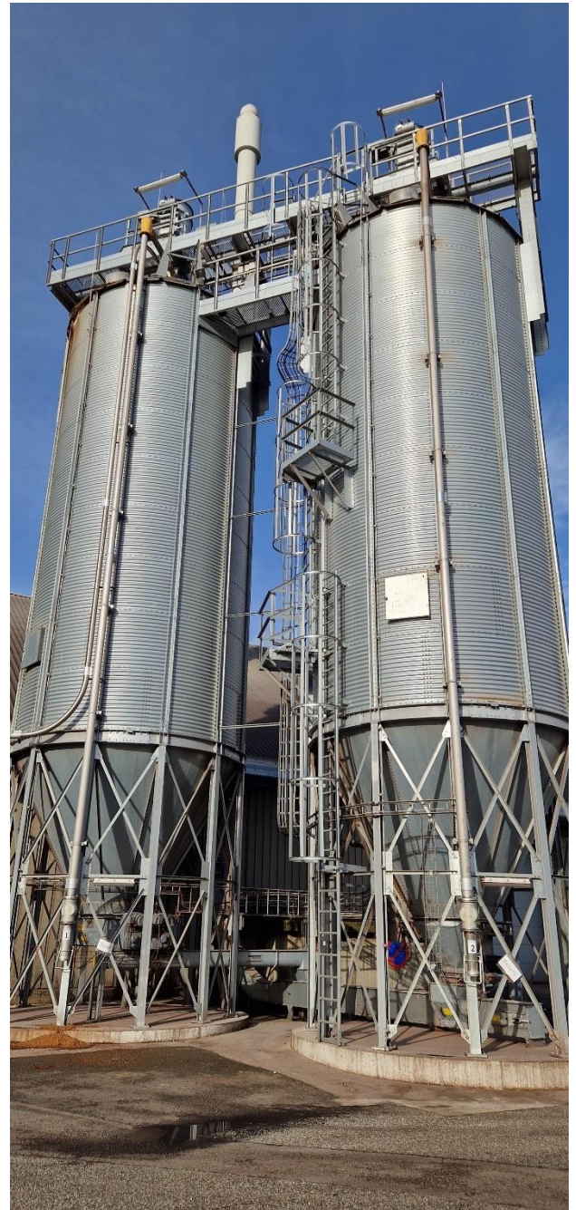
Siloer til biobrændsel ved kedelbygning.
