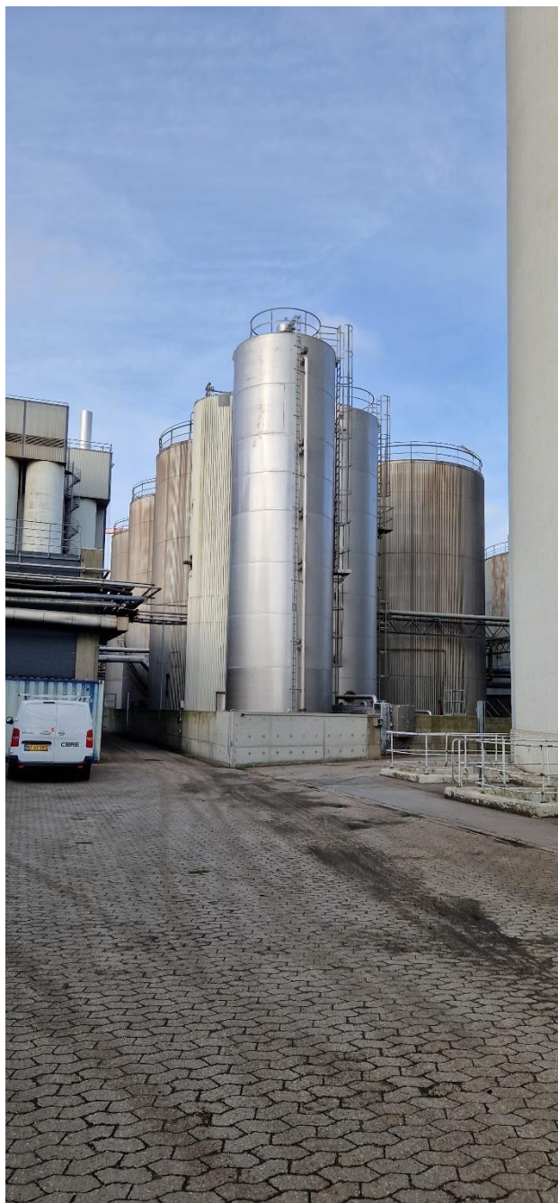
De to blanke tanke benyttes til bundfældning af stofindhold i spildevand inden afledning.
