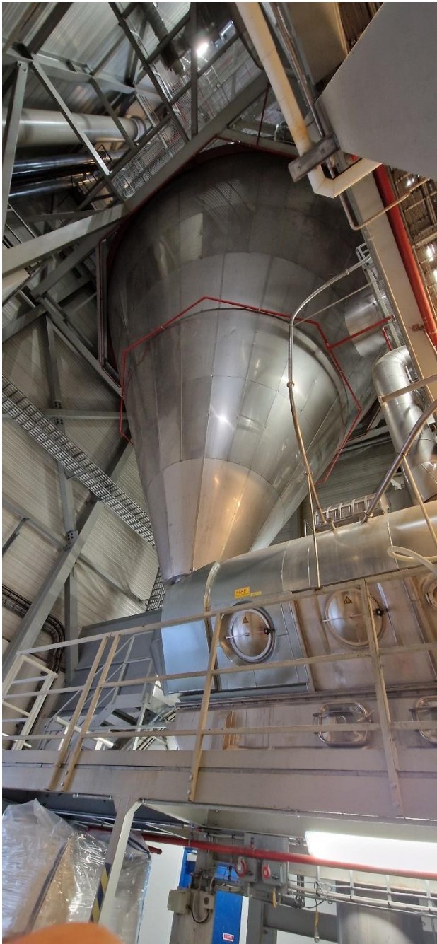
Undersiden af spraytørningsanlæg. Udsuget luft renses i cykloner og posefilteranlæg.
