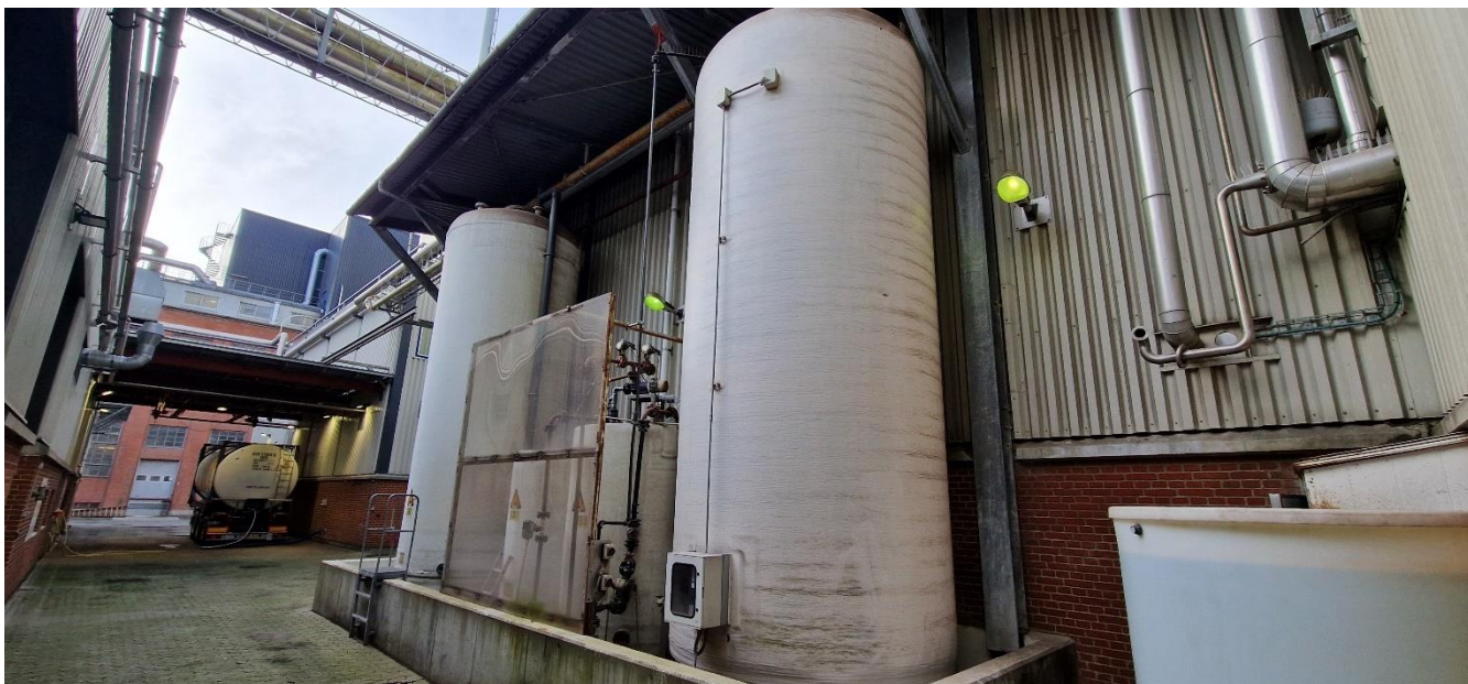
Tanke til svovlsyre og lud (natriumhydroxid) i overdækket tankgård.
