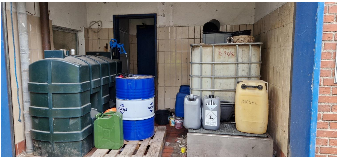
Rum ved værkstedsbygningen benyttes til dieselolietank, smøreolie og spildolie. Flere oplag er på spildbakker. Rummet er uden afløb og med opkant/hældning ved port.
