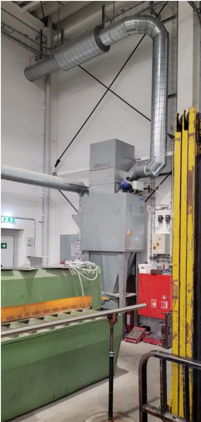
Udsugning fra metalværkstedet renses i et kuvertfilter.
