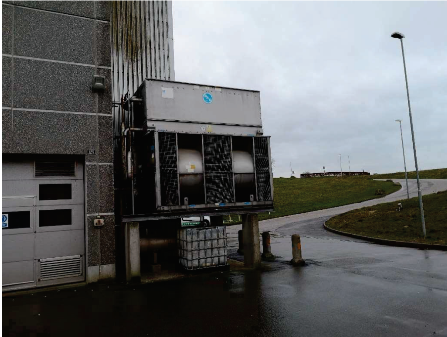
E5 Køleanlæg NV. Målt d. 21. januar 2021
