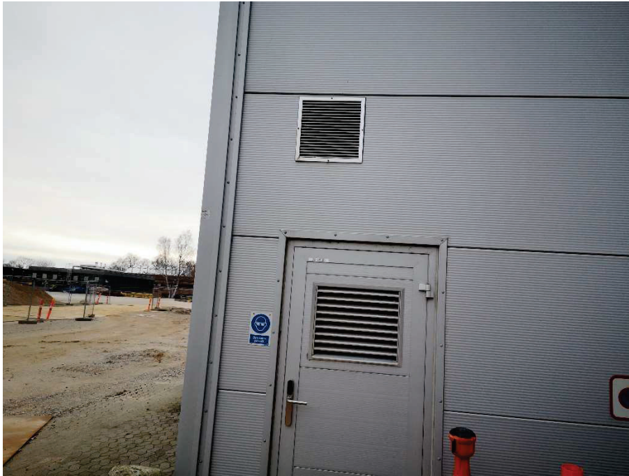
KC03 Indsugningsriste N. Målt 29/1-24
