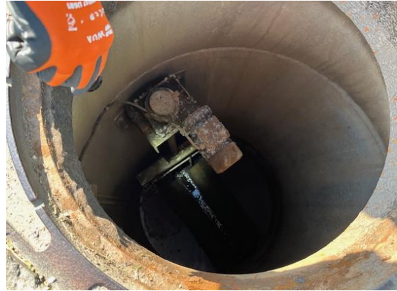
Foto 7: brønd med afspærringsventil, spildevandsledning
