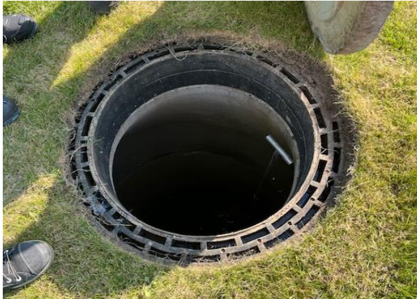
Foto 6: brønd med afspærringsventil, regnvandsledning
