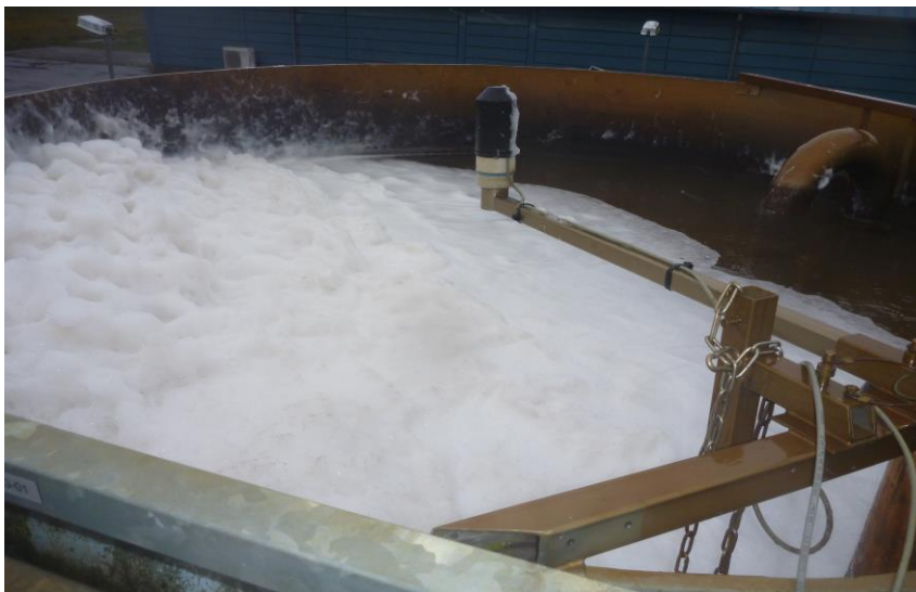
Foto 6: Den ene indløbstank ved forrenseanlægget på Odense Nord Miljøcenter.
