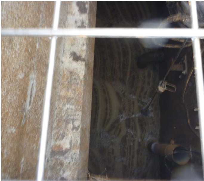
Foto 5: Miljøstyrelsen fik forevist samletank / forsinkelses bassin, hvorfra perkolatet ledes til kommunens spildevandsledning.
