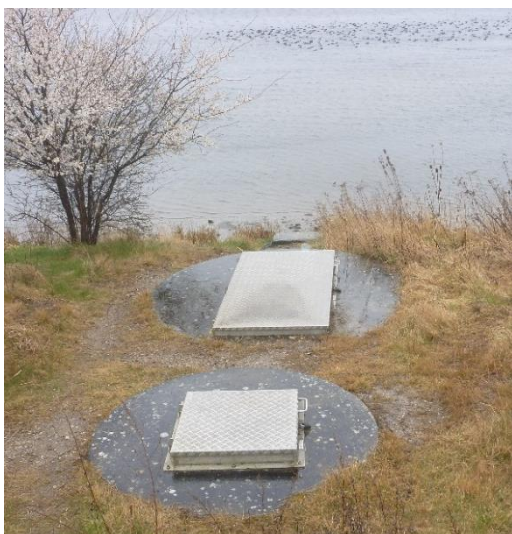
Foto 1: Brønden SØ2-RZ-05 hvorfra overfladevand kan ledes ud i kanalen.
