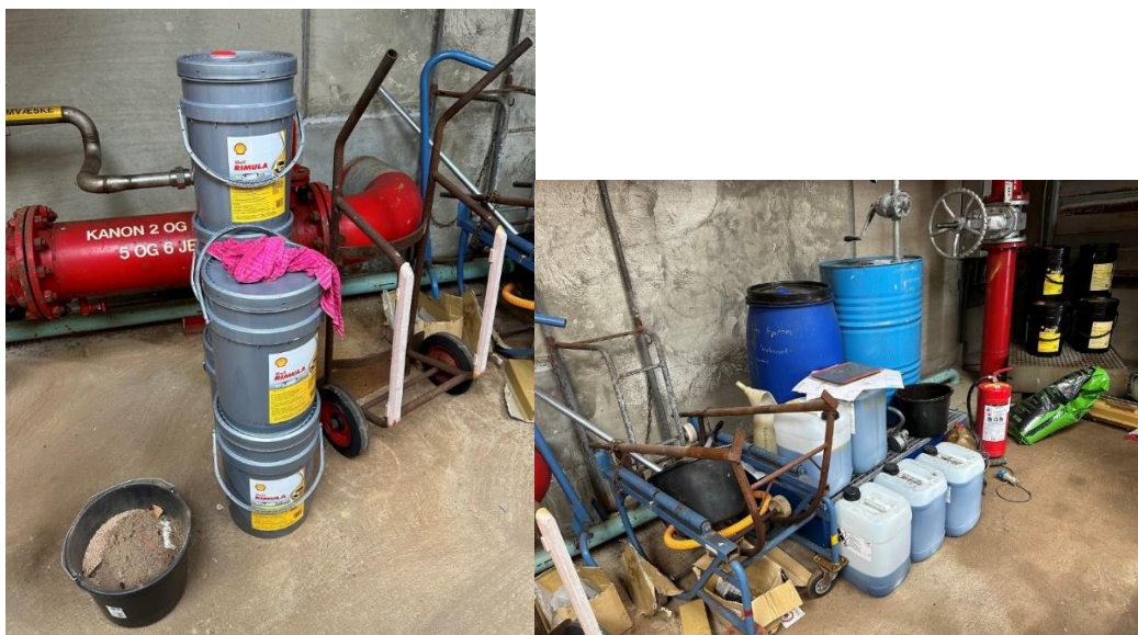
Foto 5: Kemikalieoplæg i brandpumpehuset.
