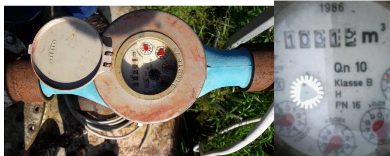
Foto 1 Måleren på perkolattanken er defekt (målerstand 30294)
