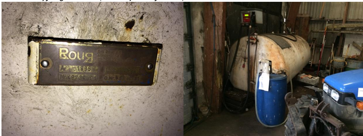
5900 liters dieseltank placeret indendørs i garage (billede fra tilsyn 2016).
