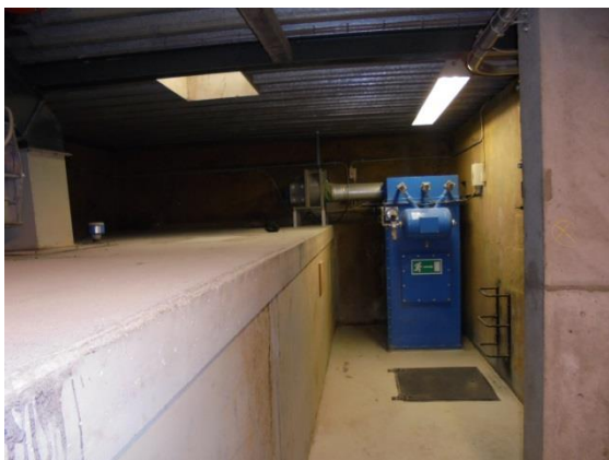
Toppen af siloer, med filter til opsamling og recirkulering af støv
