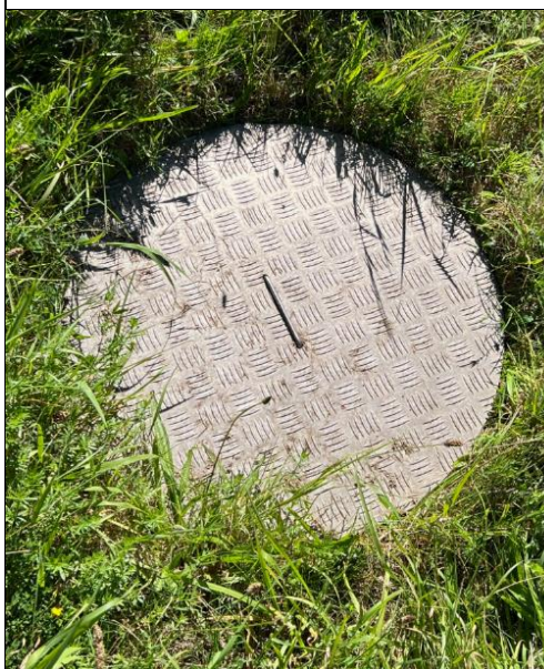
Foto 6. Brønddæksel på AV3.
