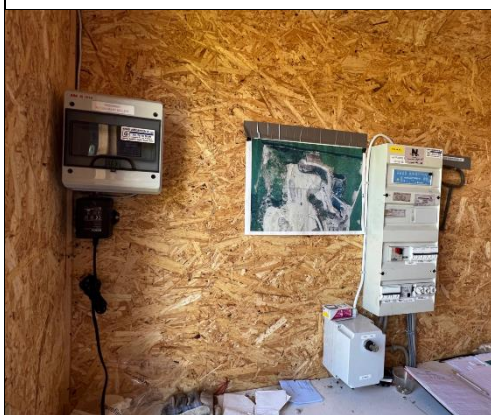
Foto 9. Skur med el-skab og overvågning mv.
