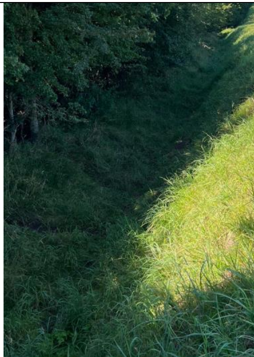
Foto 14. Afvandingsgrøft/drænggrøft mod syd
