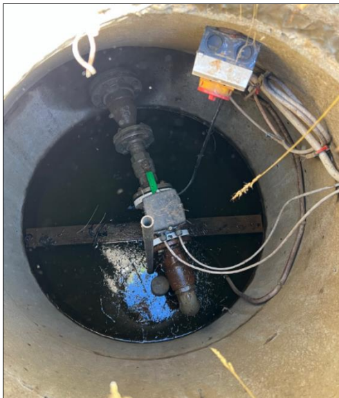
Foto 4. Afværgeboring AV2. Flowmåler, strømforsyning og prøvetagningsstuds ses på fotoet.
