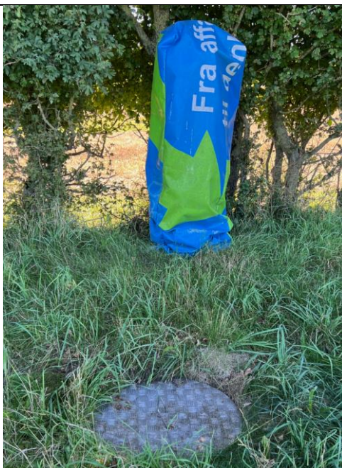
Foto 9. brønddæksel på AV4 og afdækket el-skab.
