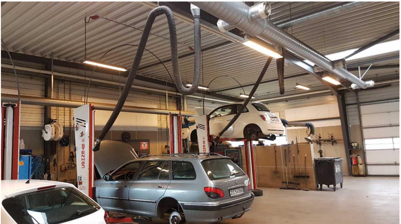
Udsugningsanlæg til udstødningsgas og bagest ved containeren er et punktudsug til svejserøg.
