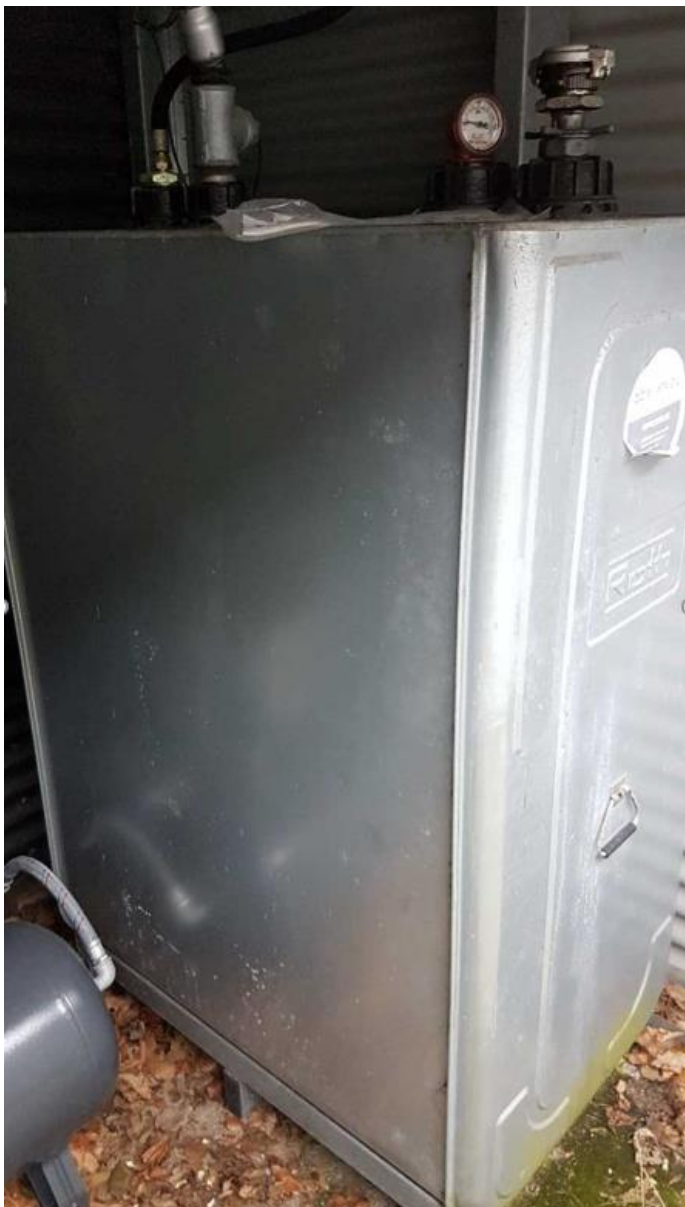
Dobbeltvægget spildolietank i skur.
