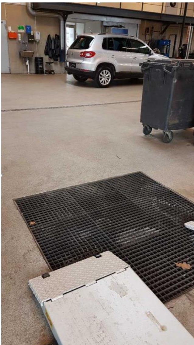
Afløbsrist og afløbsrende på værkstedet.
