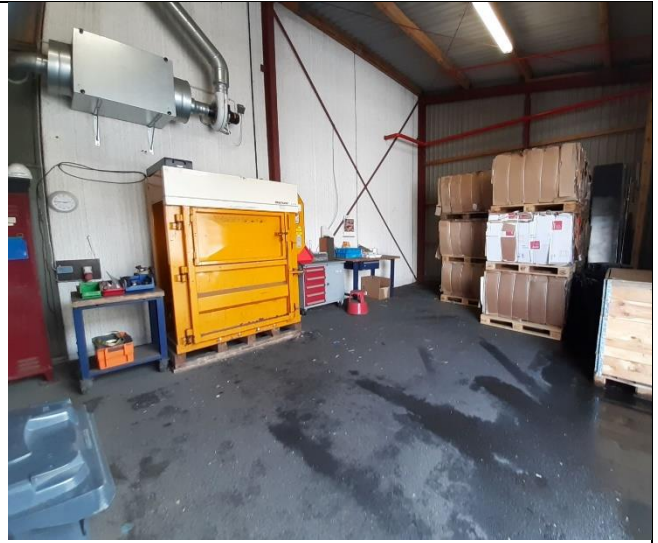
Papkomprimator i affaldsrummet
