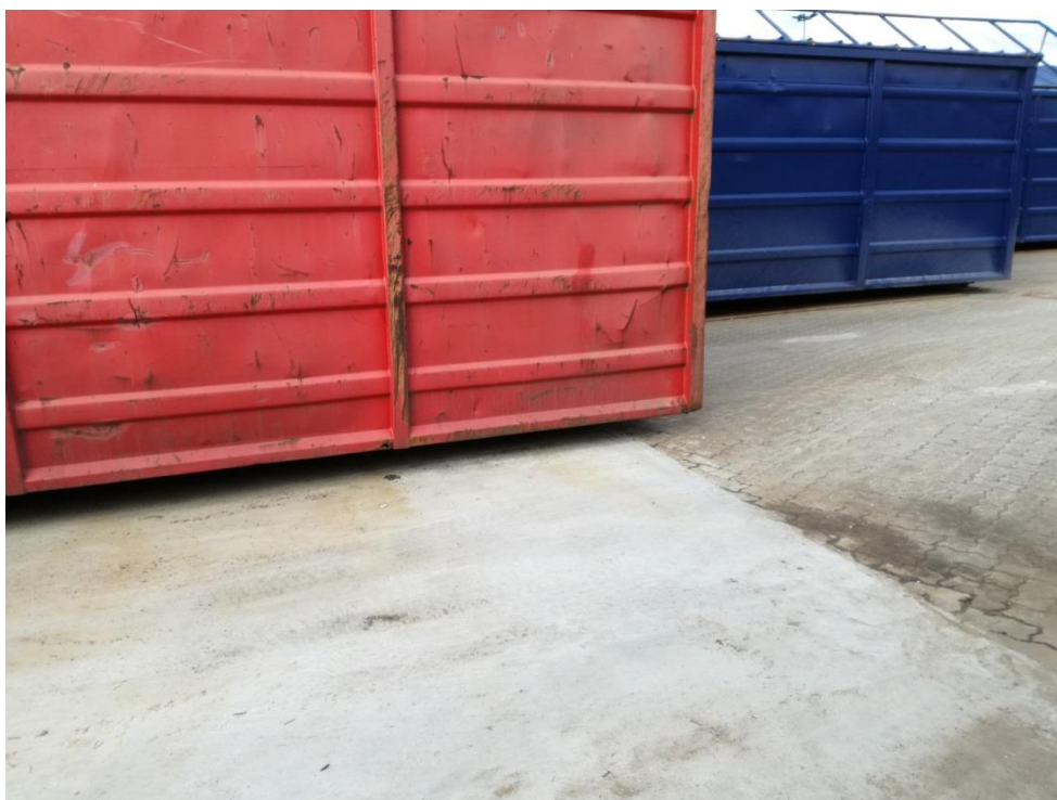
Foto af den manglende befæstelse under den ene ende af metalcontaineren.
