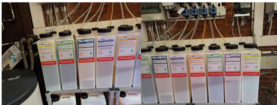
Doserede vaskemidler i teknikerrum tilhørende vaskehal 1
