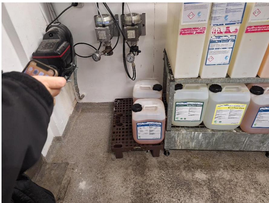
2 Vaskemidler opbevaret uforsvarligt uden spildbakker i teknikerrum tilhørende vaskehal 1
