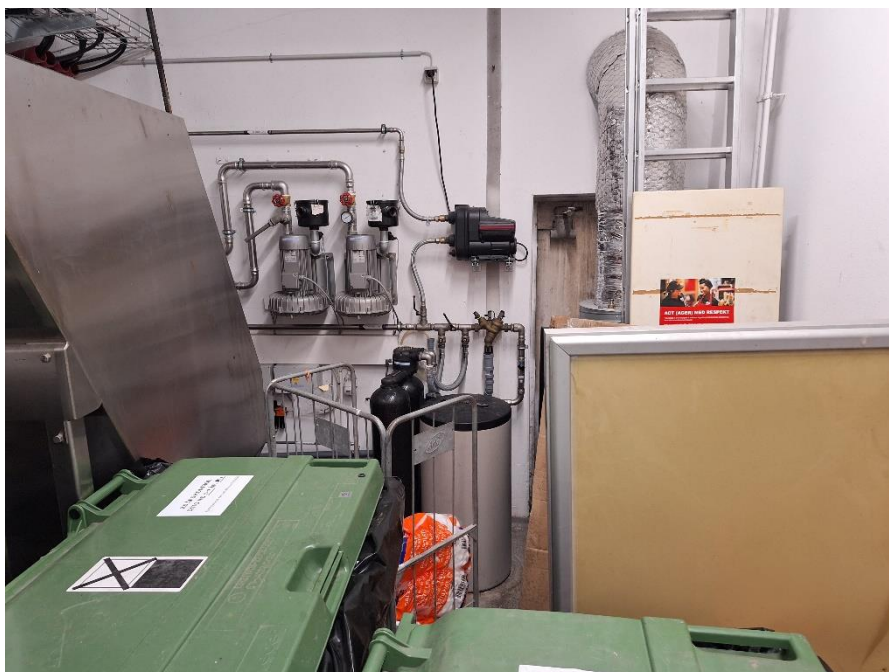
Ionbytter i teknikerrum tilhørende vaskehal 2+3
