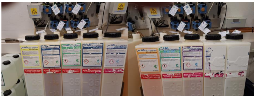
Doserede vaskemidler i teknikerrum tilhørende vaskehal 2+3
