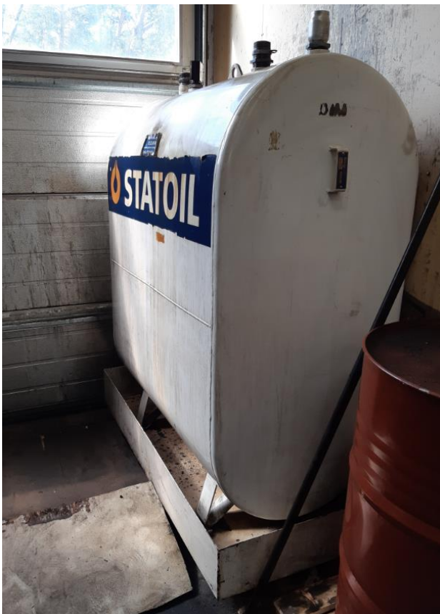
Spildolietank på spildbakke
