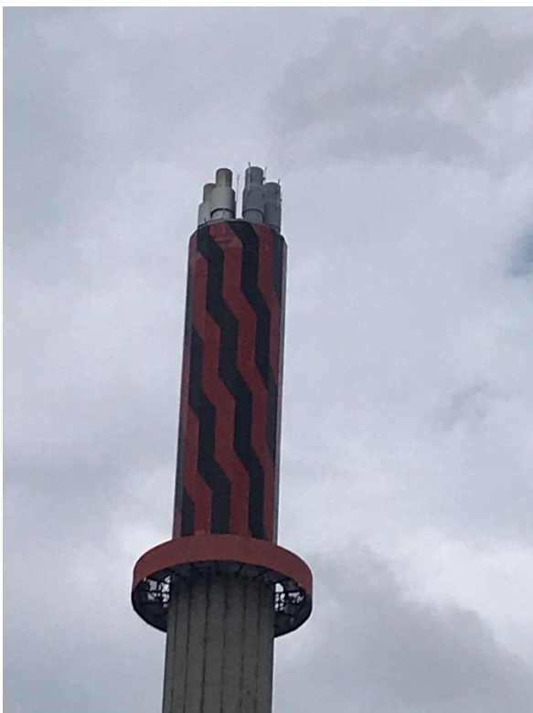
Figur 8: Skorstenstoppen, de 3 røgrør vedrører affaldsforbrænding (1 røgrør for L4, 2 røgrør for L5) , derudover er der røgrør til spidslast gaskedel, men denne vil ikke normalt være i drift sammen med de 3 primære rør.
