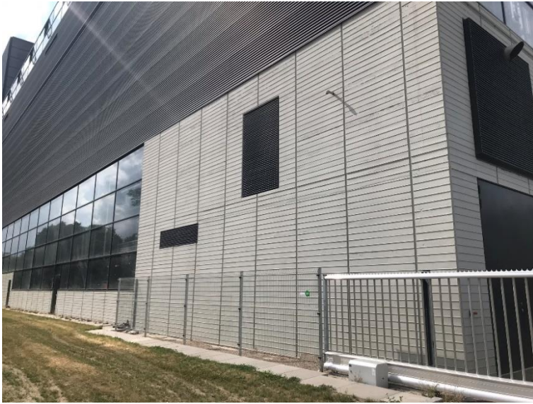
Figur 6: L5 rist1 og rist 2 i facade Ø.
