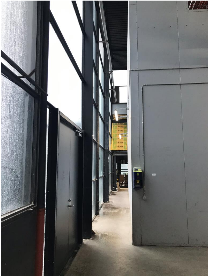
Figur 14: Facade ved varmepumper.
