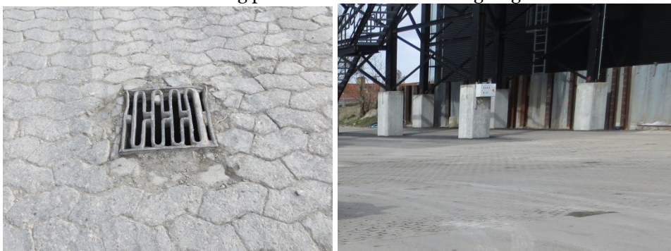
9. huller i belægning omkring afløb og afløbet kant er højere end belægningen. 10. Nærmeste afløb på modsatte side af udtaget.
