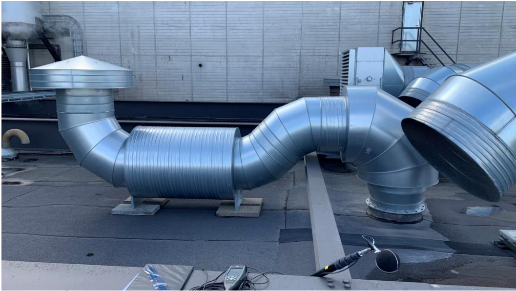
Figur 10: Varmepumpebygning luftindtag og luftfkest på tag.
