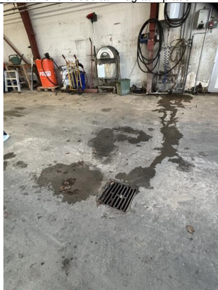
Koldhal med gulv afløb (til olieudskilleranlæg)
