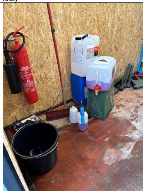
Opbevaring af vaskekemikalier i container uden spildbakke
