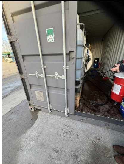
Container til ny dieseltank, 2 stk. 1.000 l AD-Blue tanke samt div. Olier (ingen spildbakke)
