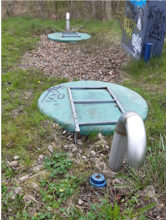
Foto 1. Pst. 65 (nord)- perkolatpumpebrønd og brønd med flowmåler
