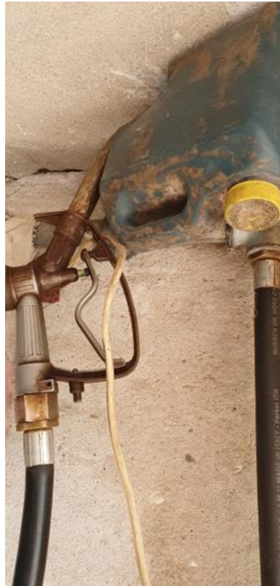
Spildsikring under påfyldningspistol.
