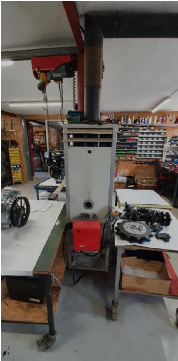
Oliefyret kalorifere på værkstedet.
