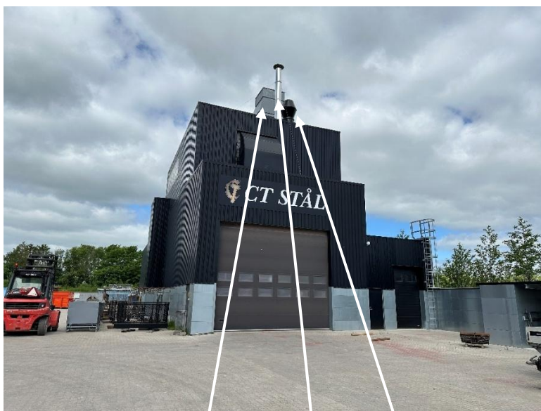
Billede nr. 10: Afkast fra malekabine, gaskedel og der er tvivl om hvad der er koblet til det sorte afkast (2026)
