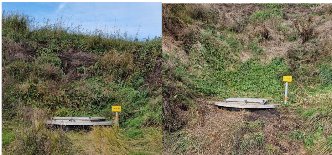
Figur 3. Perkolat brønd 1B (etape 1A) og brønd C (etape 1B).
