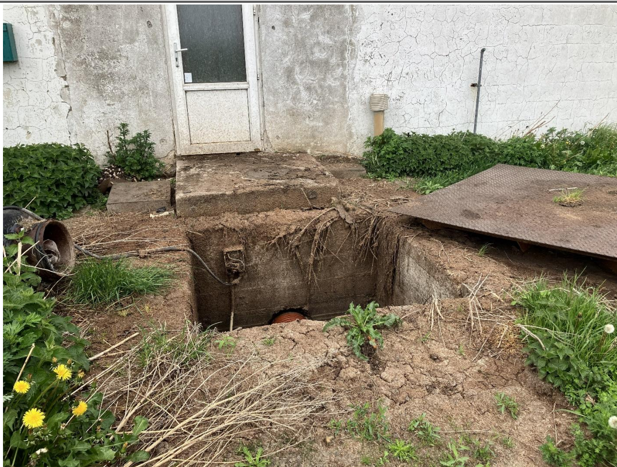
Flue- og skadedyrsbekæmpelse: Tørbrønd
