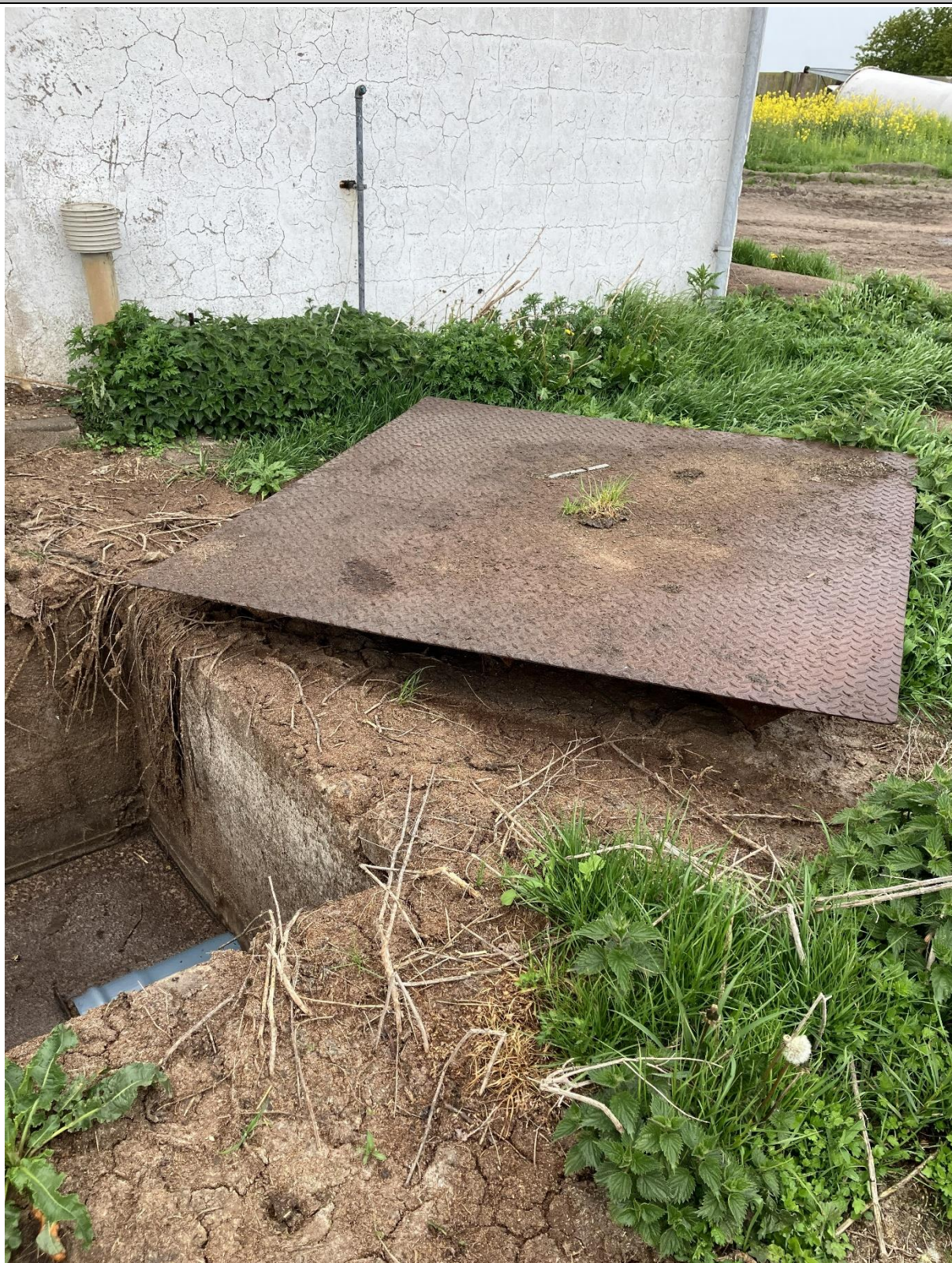
Flue- og skadedyrsbekæmpelse: Tørbrønd
