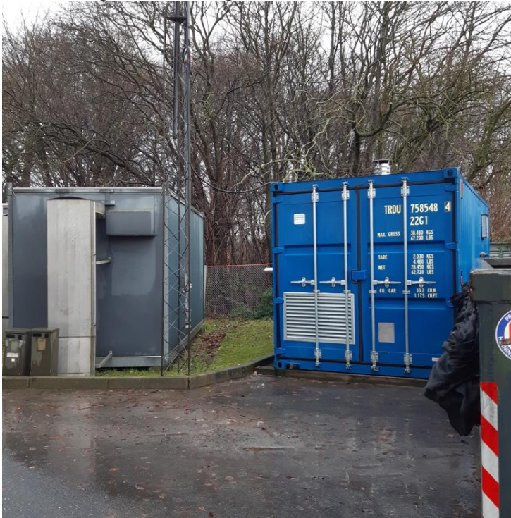
Container og tank til dieselgenerator
