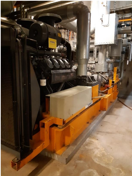
Photo: Nødfødepumpe med tank
