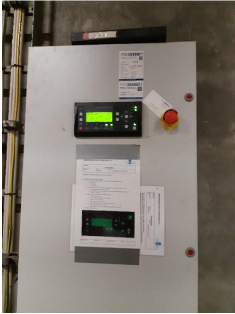
Photo: Overvågning nødgenerator
