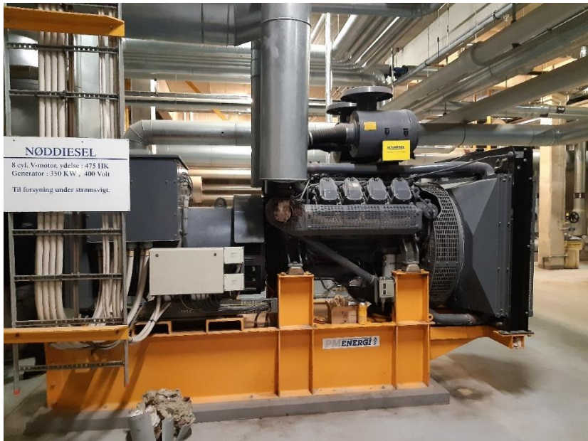
Photo: Nødgenerator med tank
