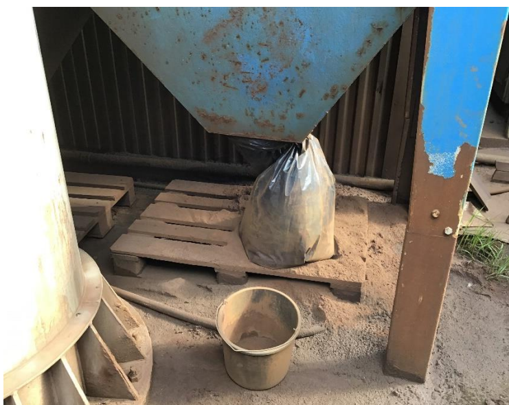
Ufuldstændig opsamling af filterstøv.
