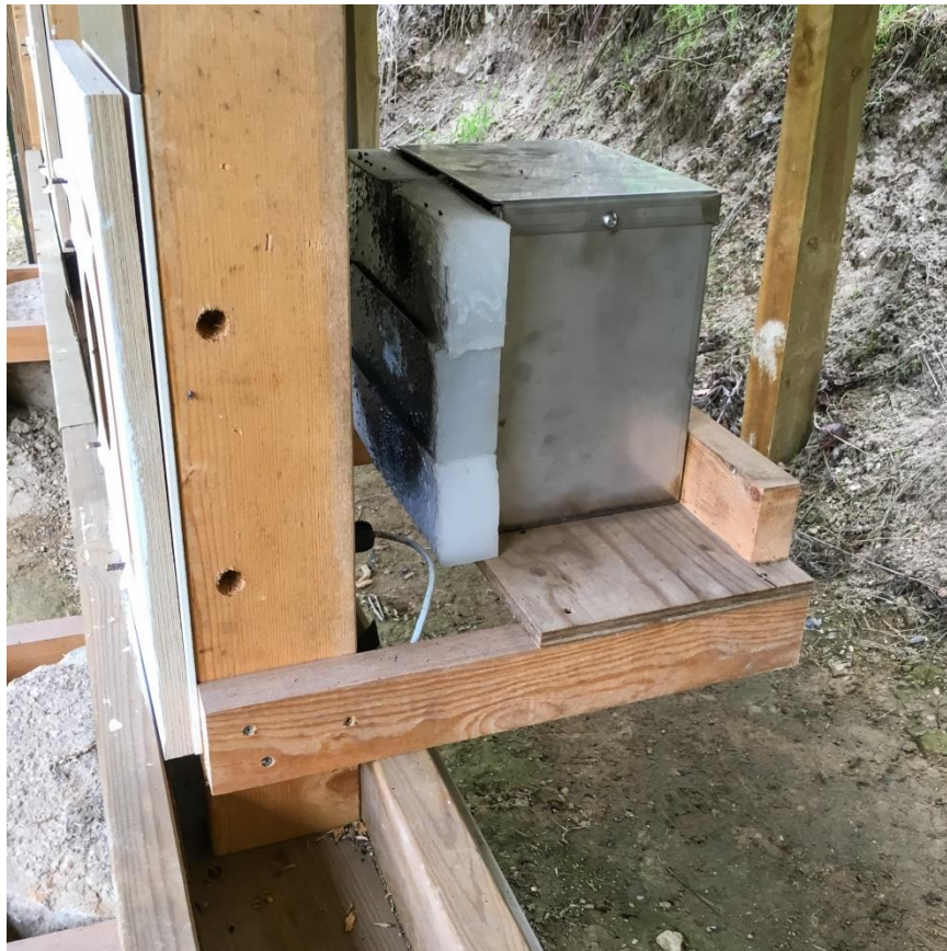
Figur 2 Kuglefangssystem på 50 meter banen. Den elektroniske skive sidder til venstre. Kuglerne opfanges i metalkassen
