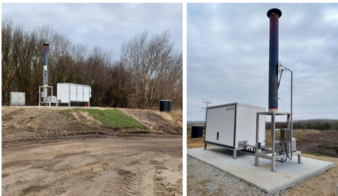
Figur 4. Fakkelanlæg. Tv: Fakkelanlæg og kondensbrønd. Th: Fakkelanlæg.
