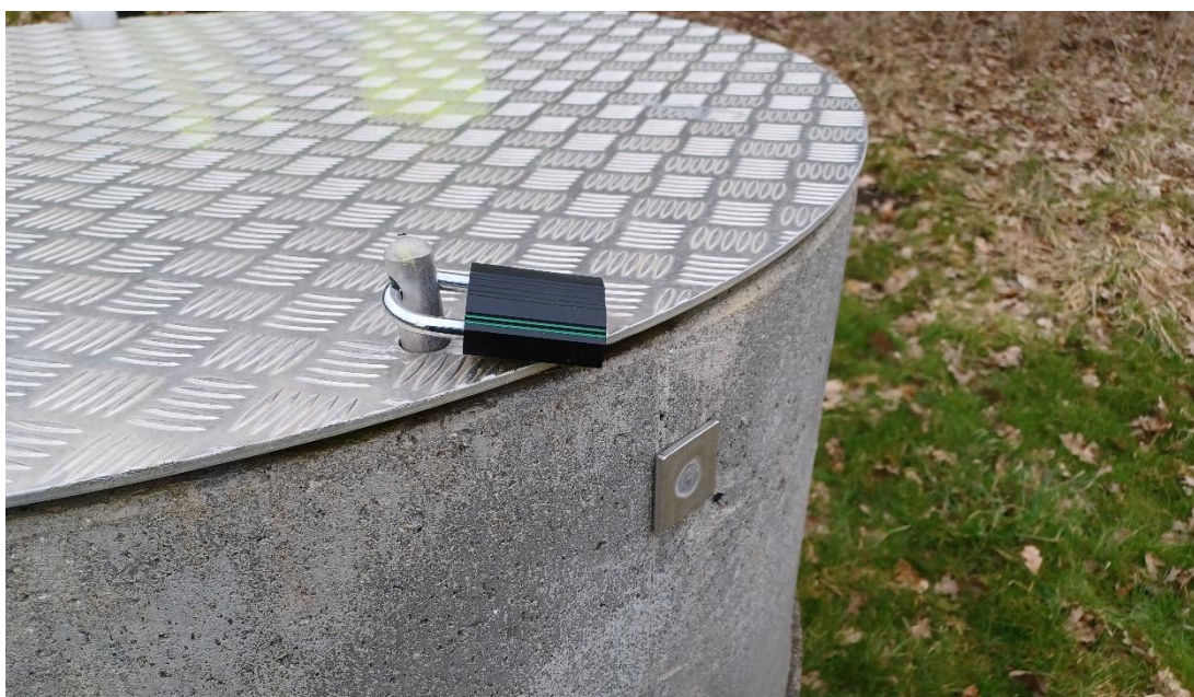
Figur 5. Perkolatbrønde mellem etape 3 og 4. Øverst: Foto fra tilsynet i 2023, hvor er der synlige overjordiske ledninger mellem brøndene BR3 (forrest) og BT4. Midterst: Perkolatbrønde med låg og nedgravede ledninger mellem brøndene BR3 (forrest) og BT4. Nederst: Lås på brønd BR3.
