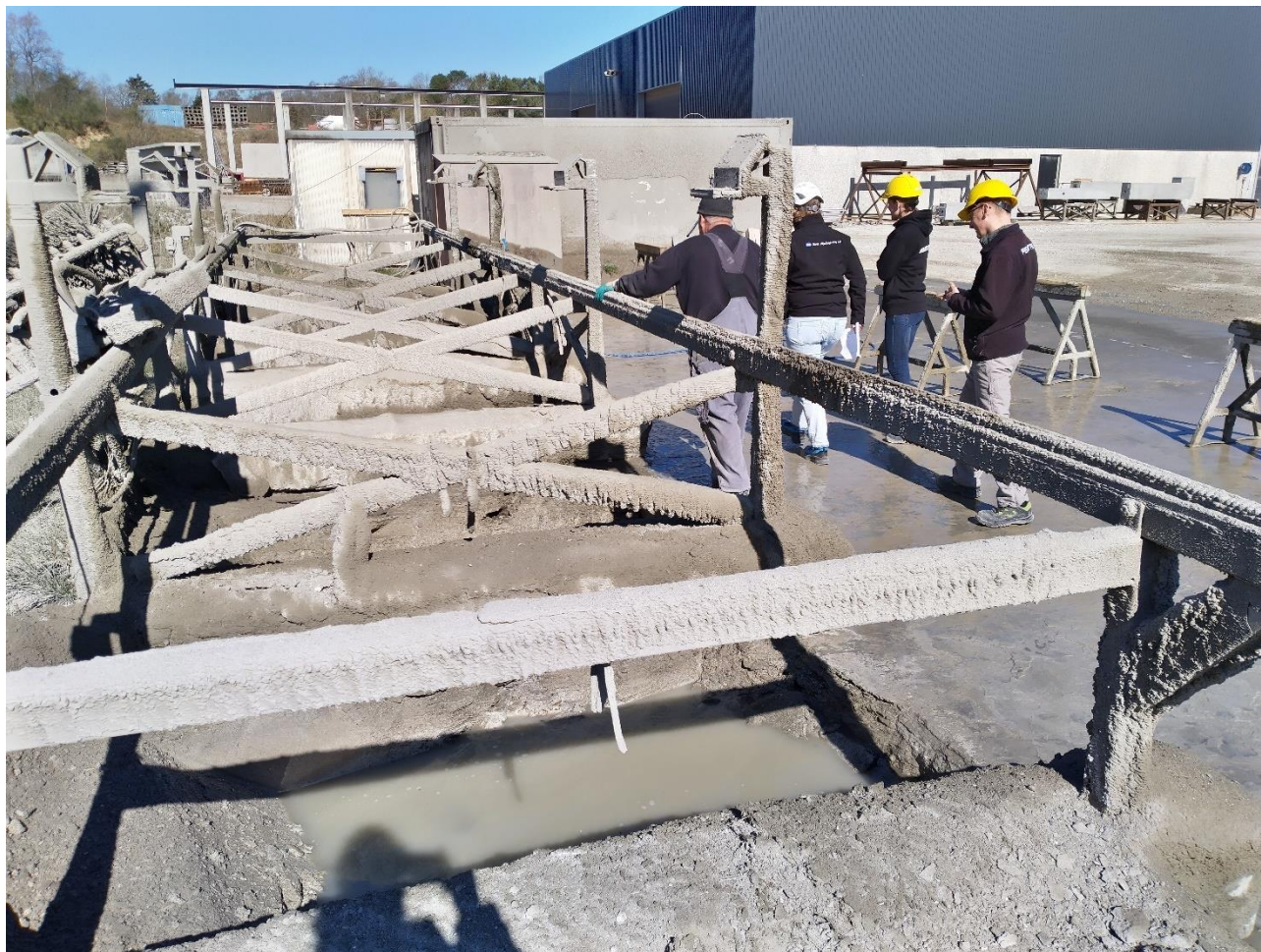
Figur 16. Vaskeplads F og G hvor elementer spules. Der ses en række mindre "kar" hvor vaskevandet opsamles, førend det ledes videre til bundfældningstank og nedslivningsgrøft
