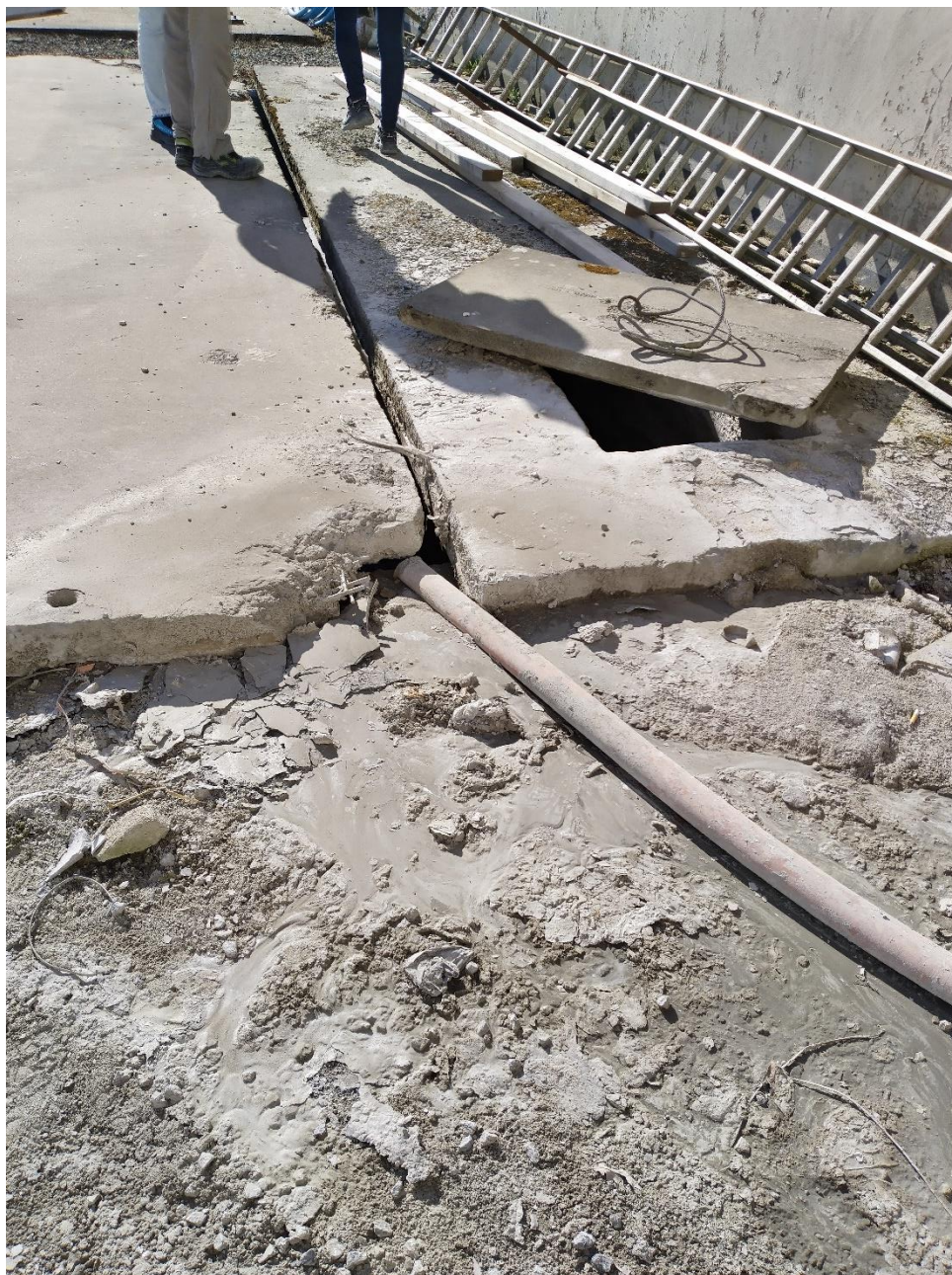
Figur 4. Udledning af vaskevand til slambassin A.
