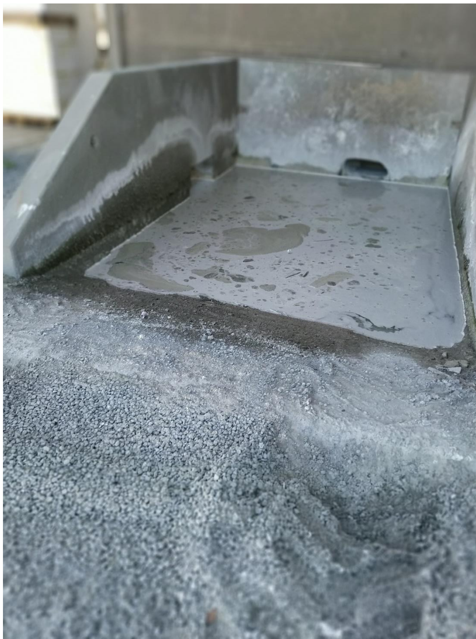
Figur 40. Slambassin I. Vand ledes til bassinet via hul i væggen.
