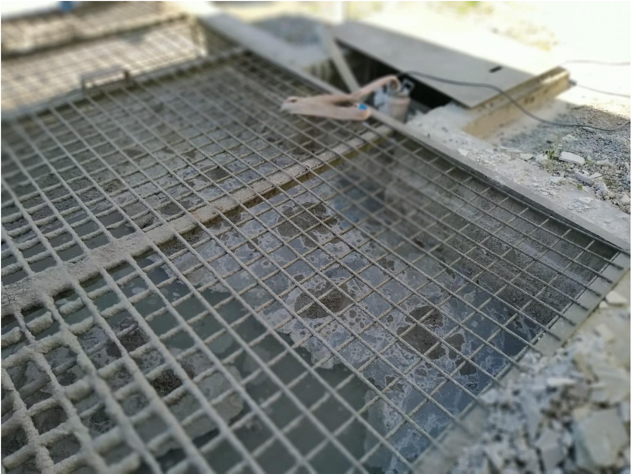
Figur 38. Vand fra slambassin E ledes via stenfilter til brønd ved hal 10.
