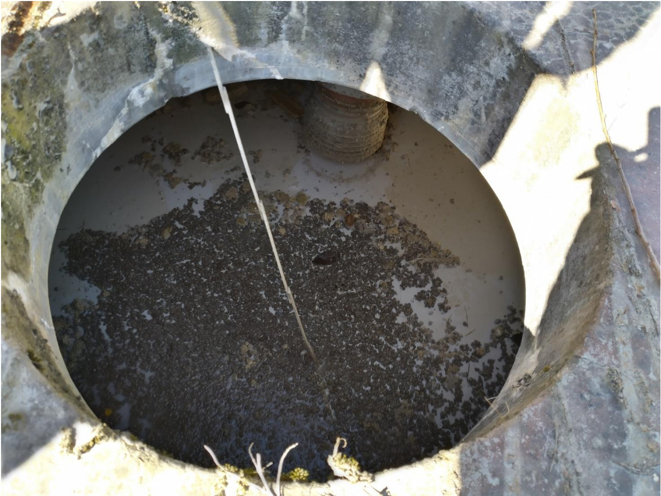
Figur 18. Bundfældningstank tilkoblet vaskepladsen. I tanken var der aflejring af Leca. Vandet ledes fra bundfældningstanken og videre til nedsivningsgrøften.
