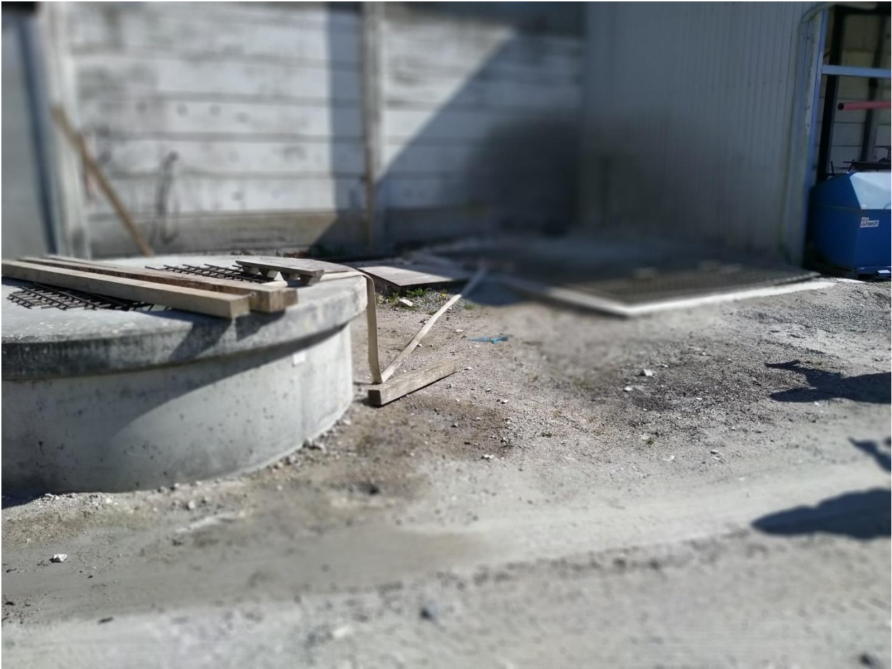
Figur 35. Den runde bundfældningstank modtager både vand fra slambassin D og E. Vandet ledes til bundfældningstank via brandslanger.
