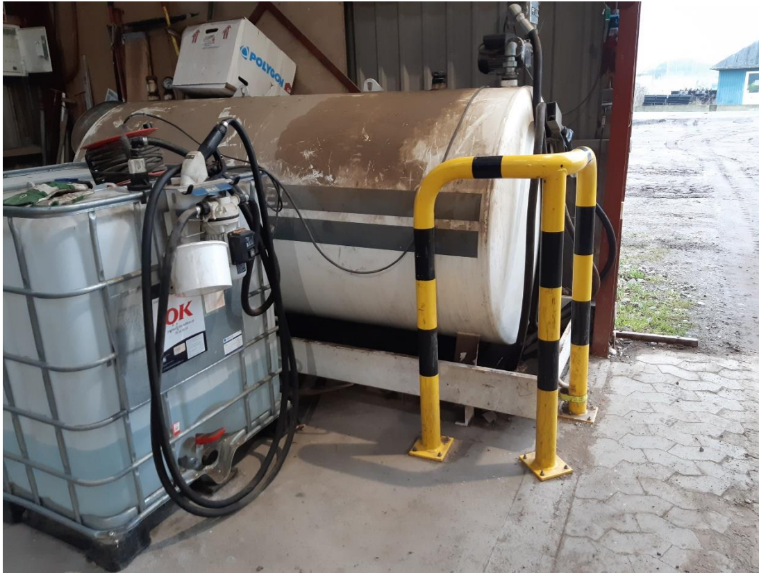
Olietank og Ad-blue i værksted.
