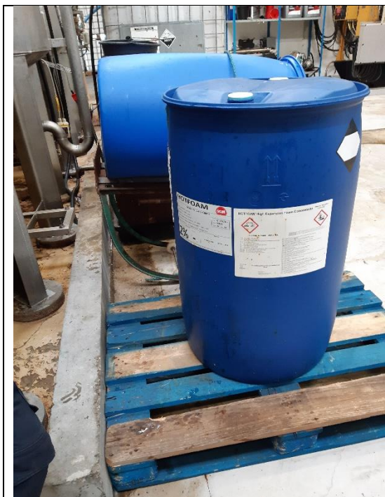
Foto 3: Beholder med skumvæske til opfyldning af den store SKUM-tank. Påfyldning udføres af servicetekniker.
