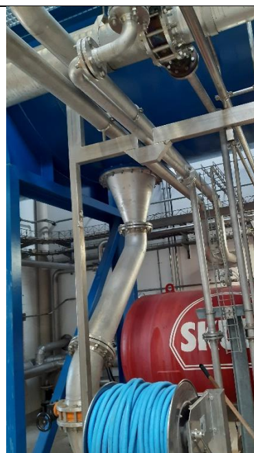
Foto 6: Rørføring fra skumanlægget i servicesbygning til bygning hvor der anvendes hexan.
