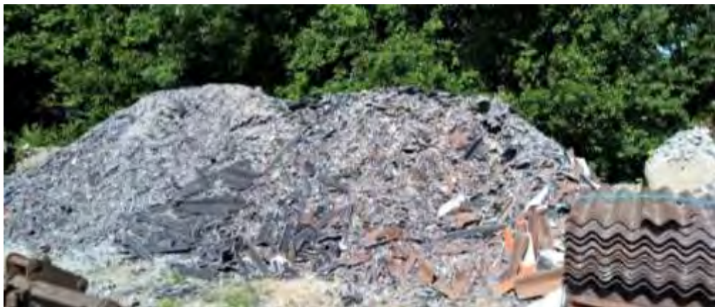
Knuste tagplader: sørg for dokumentation/analyse af, at tagpladerne ikke indeholder asbest! Foto: Aalborg Kommune
