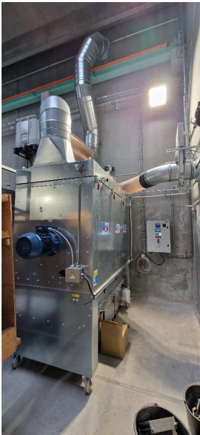
Filteranlæg fra procesanlæg.
