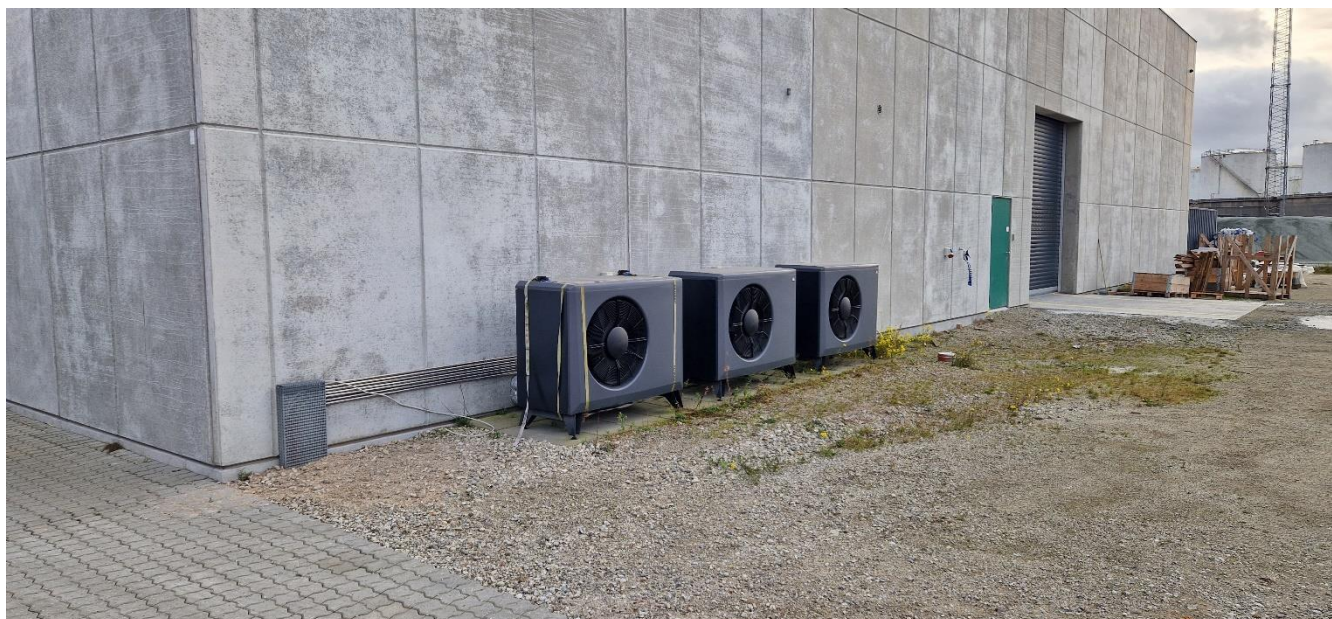
Der er etableret opvarmning via luft-vand varmepumper.
