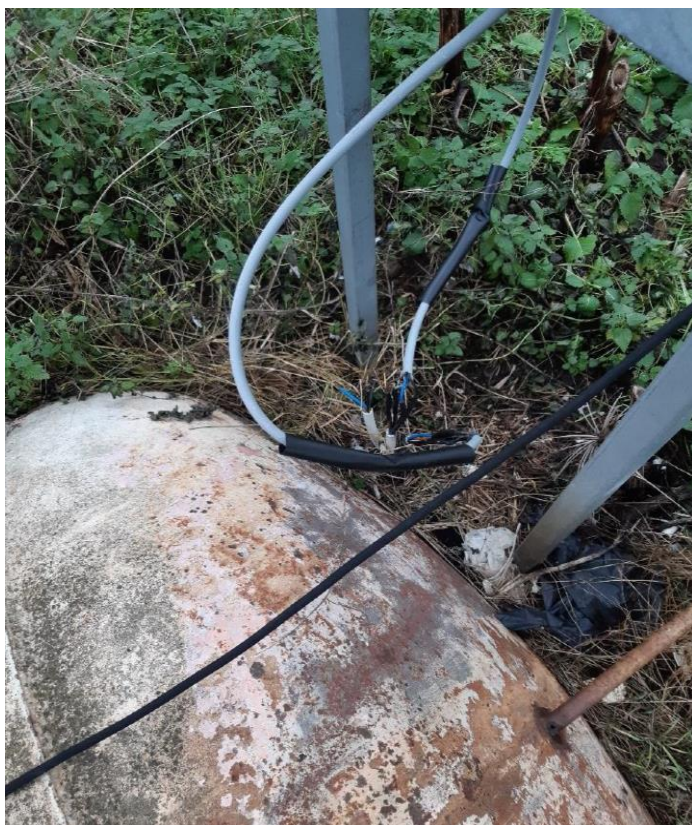
Billede 4 Overklippede ledninger til relæet, der styrer strømmen ved tilsynet d. 6. december 2022.
