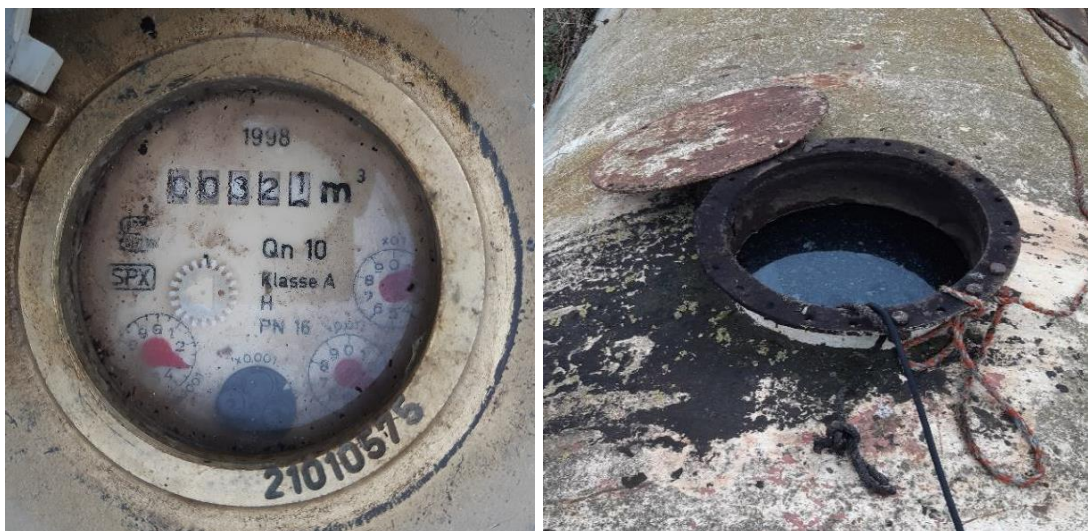
Billede 3 Måler og vandstand i tank ved tilsyn d. 6. december 2022
