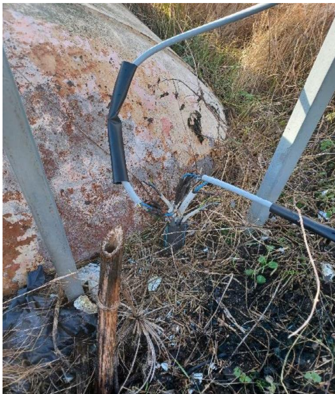
Billede 6 Overklippede ledninger ved tilsyn d. 3. januar 2023
