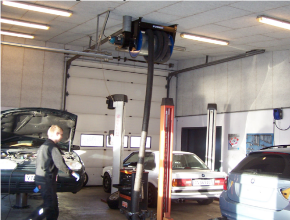
Autoværkstedet med udsugning af udstødningsgasser
