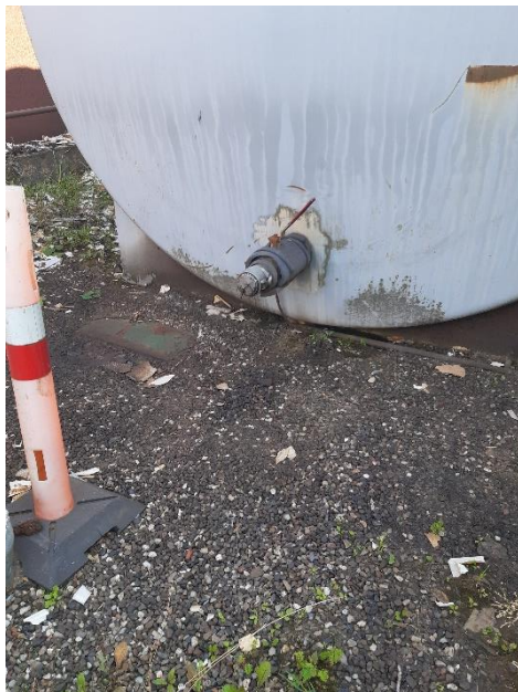
Spånoletank uden spildbakke
