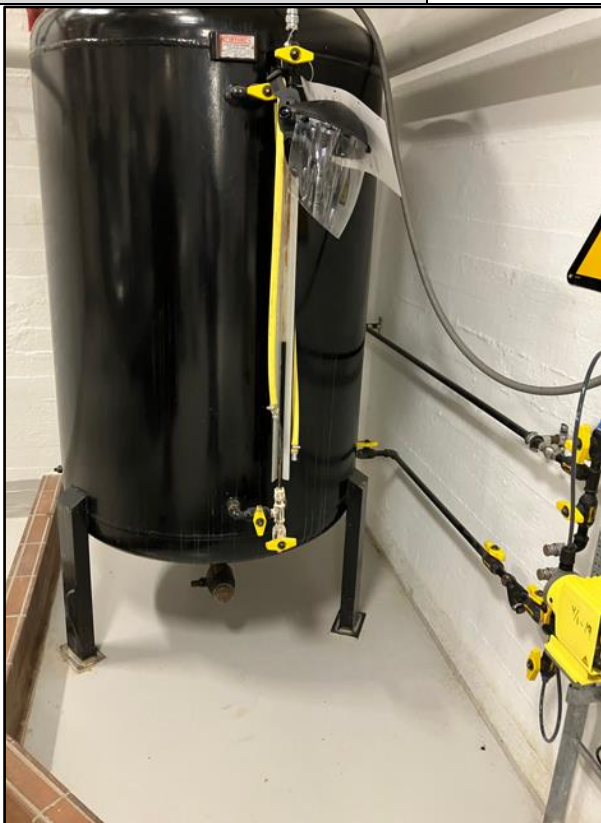
Tank til lud
