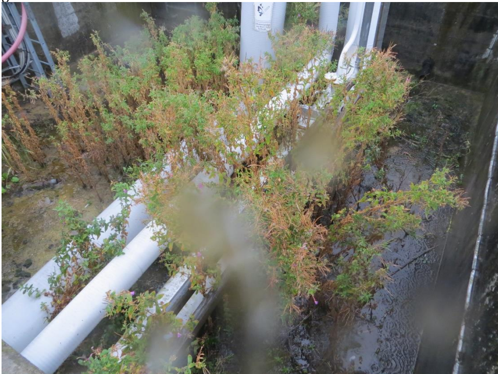
Hvor rørledninger løber under veje i betongrave, er der meget begroning. Bunden af betongravene kunne ikke inspiceres umiddelbart. Gravene bør renses op så visuel inspektion og kontrol er mulig.
