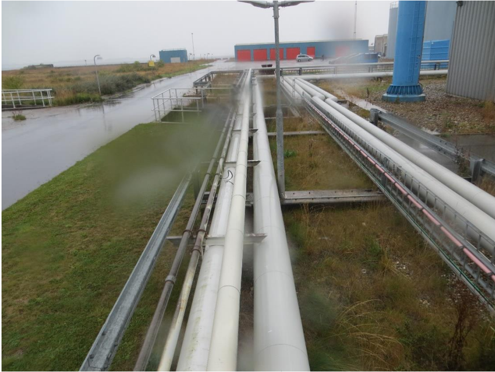
Overjordiske rørledninger der løber over ikke befæstede arealer men med afløb til grøft.
