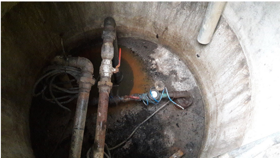
Et kig ned i boringen. Pumpeumpen er fuld og mærker på brødringene viser, at der siver vand ind i boringen.
