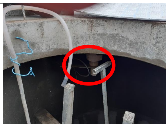
Fig. 6 Flowmåler (ultralyd) i prøvetagningsbrønd før udløb til bæk.
