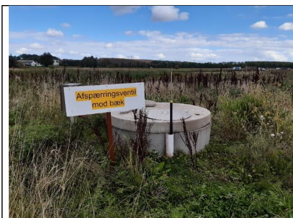
Fig. 5 Tydelig skiltning af afspærringsventil mod bæk.
