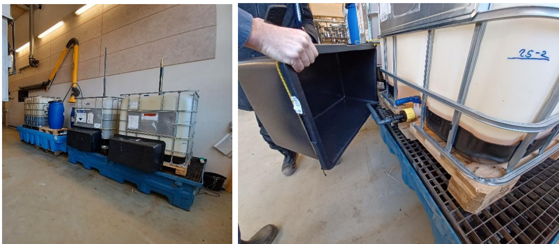
Figur 12. Korrigerende tiltag efter spild med jernklorid. Tv: oplag placeret på spildbakker med kasse over studs. Tv. Kassen agerer ekstra opsamling for at forhindre spild via studs. Spild til kasse vil blive ledt til spildbakken.
