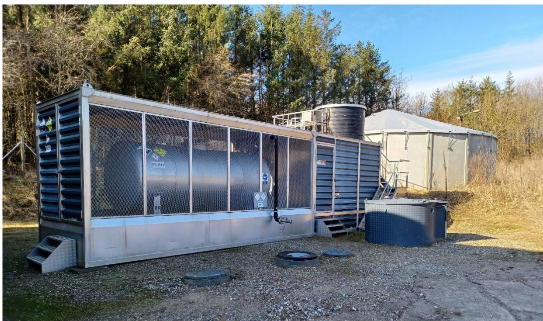
Figur 5. Perkolatforbehandlingsanlæg. Perkolatforbehandlingsanlægget er blevet flyttet fra etape 6 hen til buffertanken nord for værkstedsbygningen.
